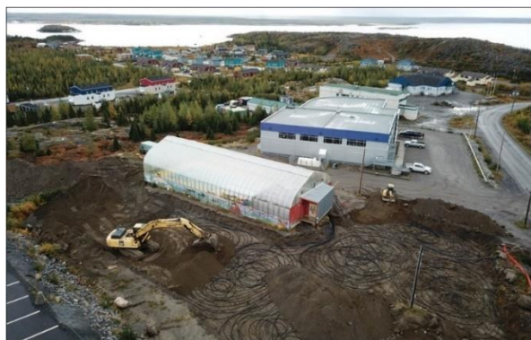
Figure 1. Aménagement d'échangeurs de chaleur géothermique pour la piscine communautaire de Kuujuaq.
